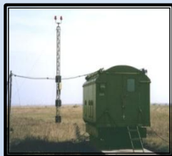
Наземное радиооборудование ПРМГ
